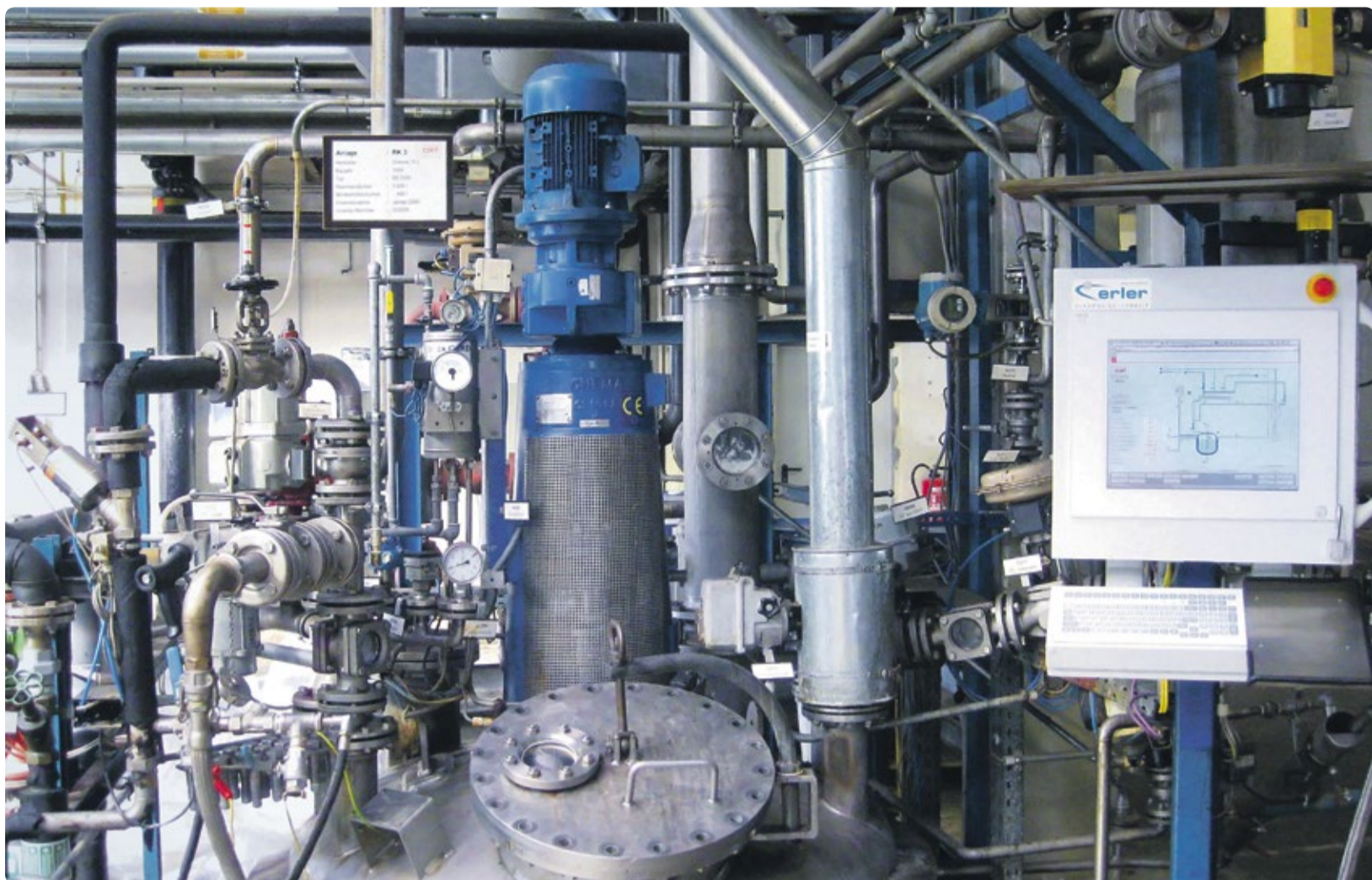
Eine der zahlreichen CHT-Anlagen in den beiden Werken in Dußlingen und Oyten, die vom Systemintegrator Erler auf das Prozessleitsystem Aproz umgestellt wurden. Die Migration erfolgte sukzessive, neue und alten Anlagenteile liefen parallel.
