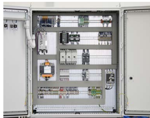
Wir projektieren und bauen Ihnen Schaltschränke nach der UL 508A
