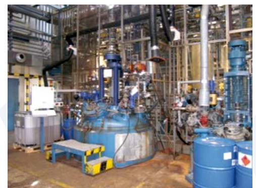
Umstellung von Anlagen auf neue Prozessleittechnik – mit APROL ohne Produktionseinbußen machbar
