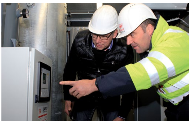
Anlagenbauer Robert Baisch (links) und CHT-Technikleiter Günther Schätzle begutachten die aktuellen Werte der Stickstoffherzeugung.
